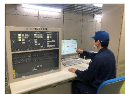
信号保安設備点検
